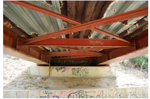
(b) Vista del estribo derecho y corrosión en forjado
