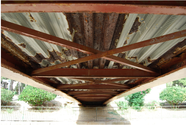
(a) Corrosión en chapa colaborante de forjado.
